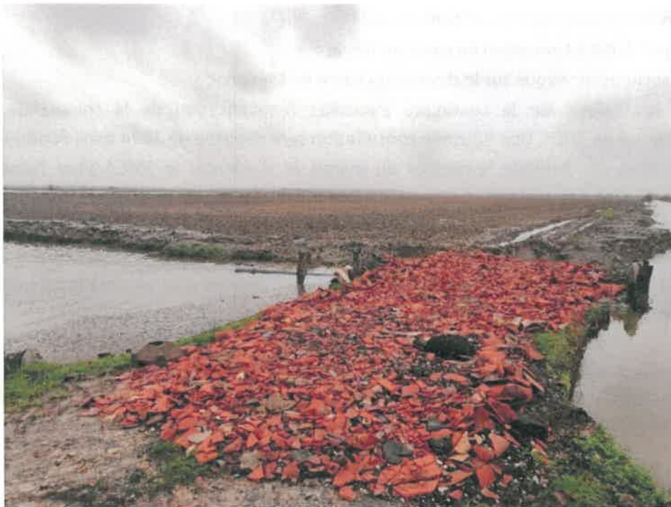
Figures 10 et 11 : endiguement sauvage avec dépôt de tout-venant, novembre 2023. (source CARO)
